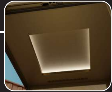
RECESSED LIGHT CEILING ไฟเพดานในลิฟต์ เป็นแบบโคมไฟ ติดเพดาน
